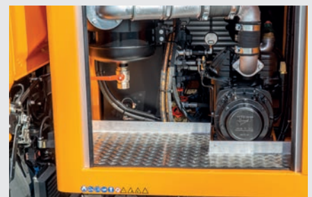
Alu-Riffelblech-Boden im Pumpenraum
